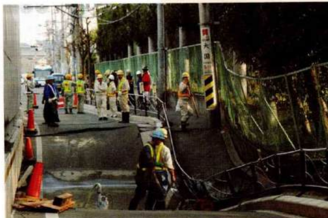
新城高校のフェンス(右) もたわんだ平成20年4月の道路陥没
